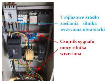
Rys. 1.13. Czujnik do pomiaru mocy prądu silnika wrzeciona zamontowany bezpośrednio w układzie sterowania CNC [26]
