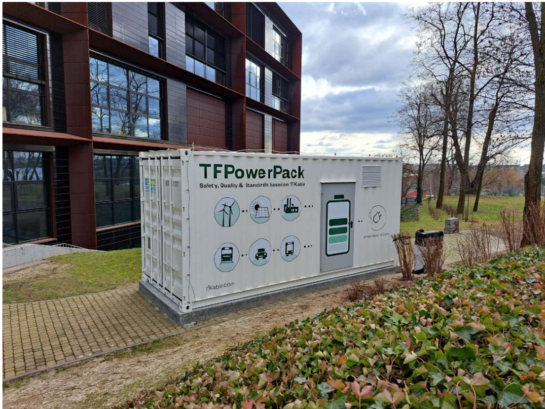
Rys. 19 Innowacyjny modułowy, mobilny magazyn energii zainstalowany i uruchomiony przed budynkiem Centrum Innowacji i Zaawansowanych Technologii Politechniki Lubelskiej [64]
