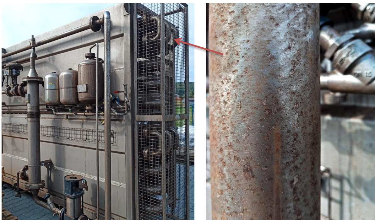
Rys. 6. Korozja wżerowa na powierzchni urządzeń ze stali nierdzewnej, pracujących w środowisku zawierającym chlorki - zdjęcia własne
