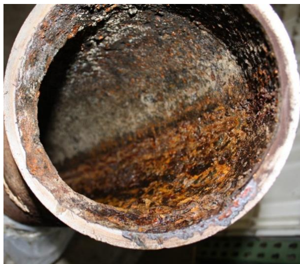
Rys. 9. Przykład korozji mikrobiologicznej [35]
