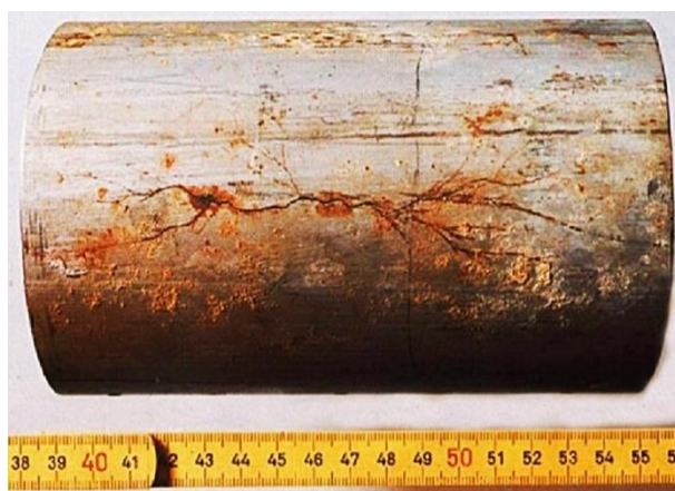
Rys. 8. Przykład korozji naprężeniowej rury parowej pod warstwą izolacji [34]
